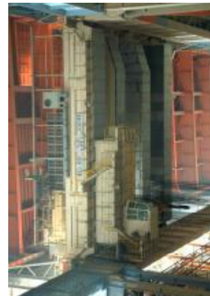
450t 铸造起重机 450t Ladle Crane
